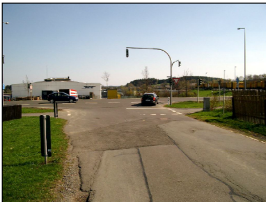
Foto 9: Sanierungsbedürftiger Fahrbahnbelag im Gewerbegebiet „Kulmbacher Straße Nord“
